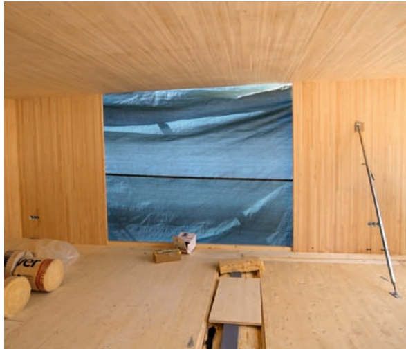
Die Rippendecken (links) für die Geschosse wie für das Dach waren massgenau vorgefertigt, ebenso die Wandelemente (rechts) mit den Sichtlagen in Lärchenholz.
